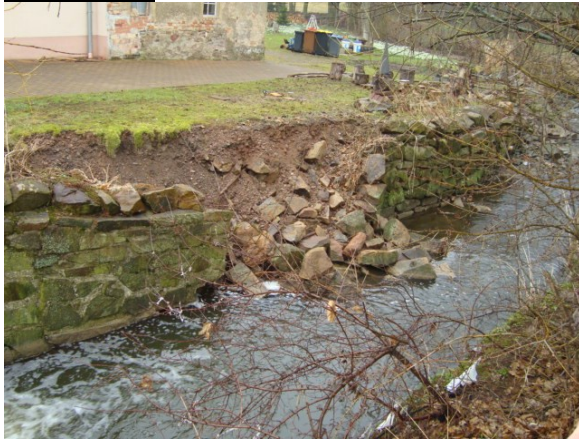
Zustand vorher - Eingestürzte Ufermauer, Absturz
