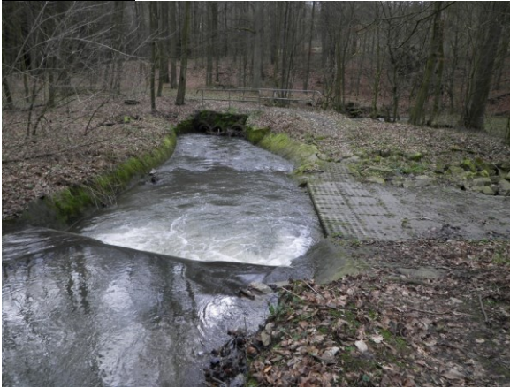
Zustand vorher – Brückenverrohrung (Hintergrund), Uferverbau beidseitig, Überlauf zur Hochwasserentlastung (Mitte rechts), Löschwasserentnahmestelle mit Absturz (Vordergrund)
