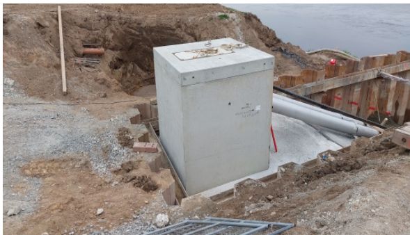
Abb.7 Pumpenschacht mit Rohrleitungen
