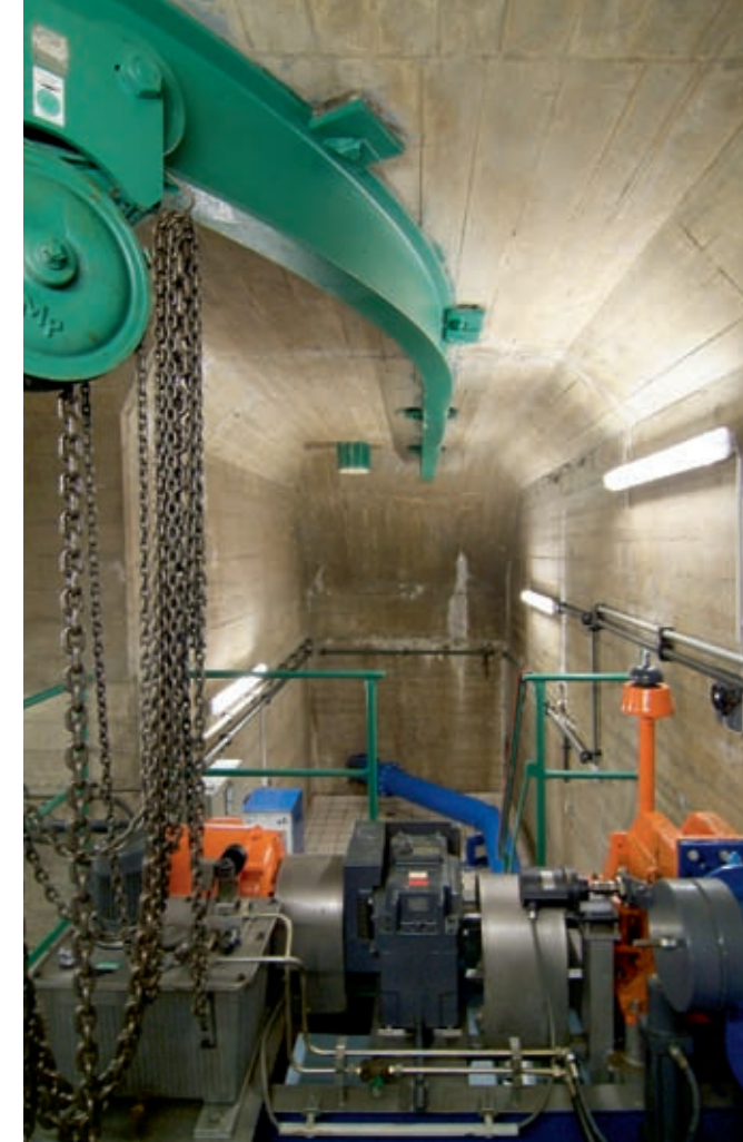
Talsperre Falkenstein: Wasserkraftanlage in der Schieberkammer
