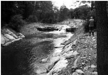
Abb. 4: schadhaftes Wehr in Müglitz Juni 2005
