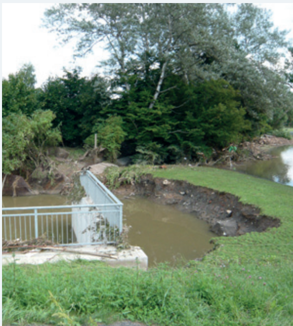
Abbildung 9-18: Ostritz, Kolk am Sielbauwerk (Foto: LTV)
