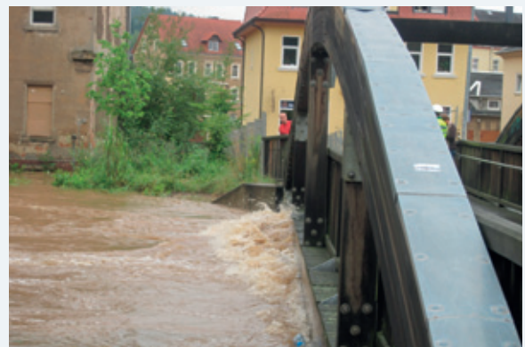
Abbildung 9-60: Einstau Brücke Hönickasteg (Foto: LTV)
